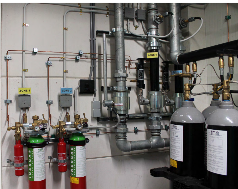
CO2-installatie (© Federatie Veilig Nederland)
